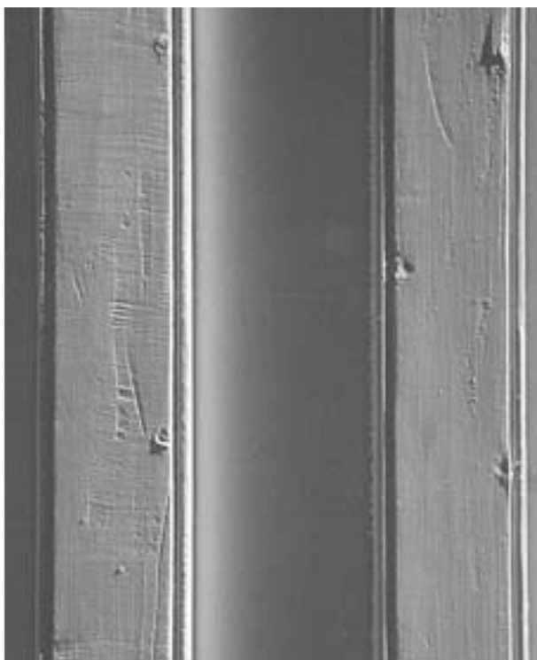
Gömul timburklæðning þar sem búið er að fjarlægja gamla málningu. Notaður var málningaruppleysir og öll gömul málning skafin inn í við. Yfirborð viðarins er skemmt og fullt af rispum. Menntaskólinn í Reykjavík, byggður 1846.
