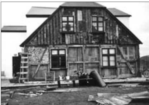
Viðgerðir á klæðningar utanhúss hófust 1996. Undir forskallingunni var ryðgað bárujárn á tjörupappa. Undir bárujárninu var strikuð vatnssklæðning. Undir vatnssklæðningunni leyndist listasúð, en listarnir höfðu verið fjarlægðir. Margt bendir til þess að þetta sé sama klæðning og á myndinni frá 1890. Í bindingsverksgrindinni var ýmist tígullsteinn, grjót eða mosi. Listasúðin var það illa farin að ákveðið var að endurnýja hana.
