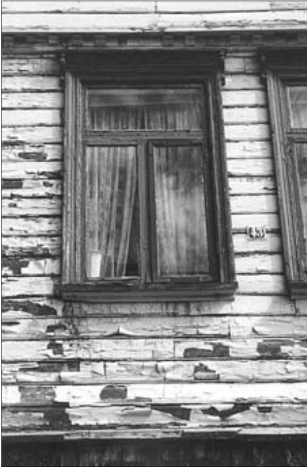
Skemmdir á timburklæðningu. Málningin flagnar af og neðstu borðin bólga út. Bendir það til þess að grindin sé fúin. Laufásvegur 43, Reykjavík.
