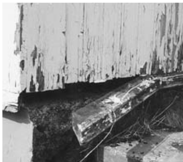
Fúaskemmd útveggjklæðning úr timbri.
