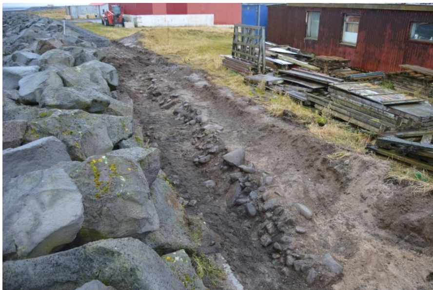
Mynd 39. Lónshús í Garði. Búið að moka vélorpnu garðlagi í burt en undir því er vélorpinn sjóvarnargarður. Ljósmynd: Stefán Ólafsson.
